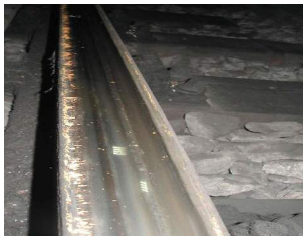
Foto 2. Șine uzate și aplatizate excesiv care existau în cale la Metrorex.
